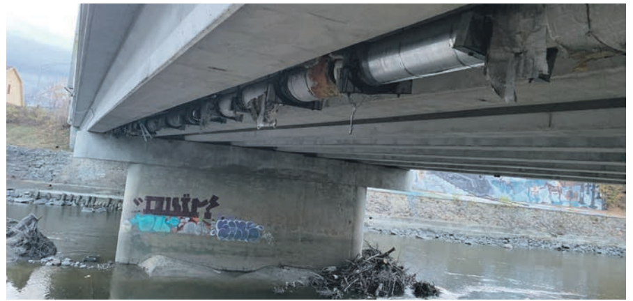
Cette conduite doit être remplacée.
