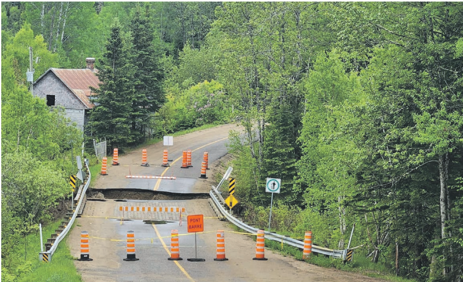
La structure du pont du rang Saint-Jérôme a été atteinte. Photo Lisianne TREMBLAY
