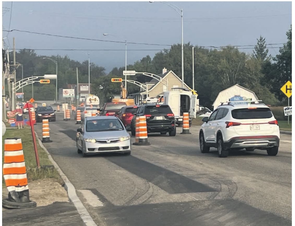
Les travaux entre Clermont et La Malbaie ont quelques semaines de retard. Photo Le Charlevoisien
