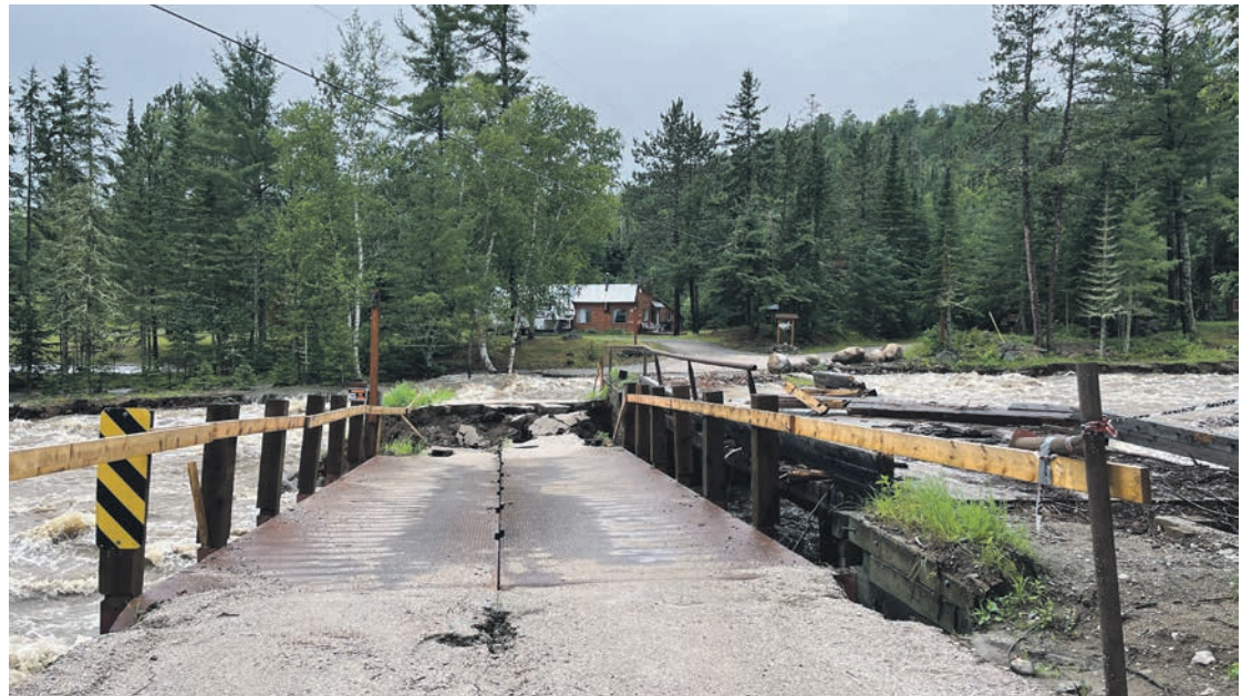
La rivière du Gros Bras a pris le dessus sur le pont temporaire, isolant cinq résidences.
