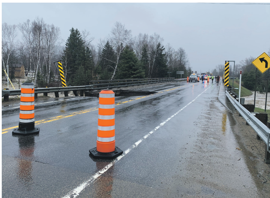
Le pont de la route 138, près de la Laiterie Charlevoix, s'est affaissé, forçant sa fermeture. Plusieurs roulottes du camping Le Genévrier, emportées dans les eaux de la rivière des Mares, sont venues s'écraser sur sa structure. Photo Dave Kidd
