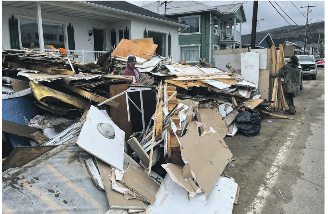
Des personnes sortent les débris d'une maison de la rue Leclerc.
